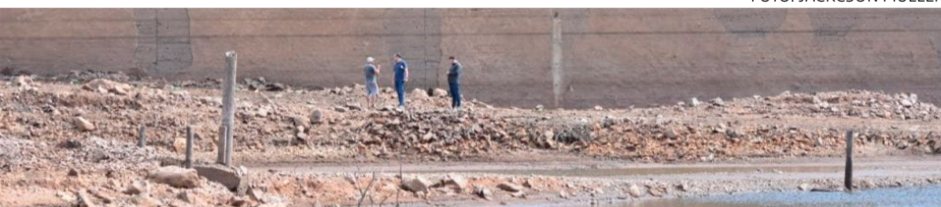
15 metros abaixo do nível normal, na barragem dos Blang, técnicos ficam pequenos ao lado do muro, no dia 13 de maio
