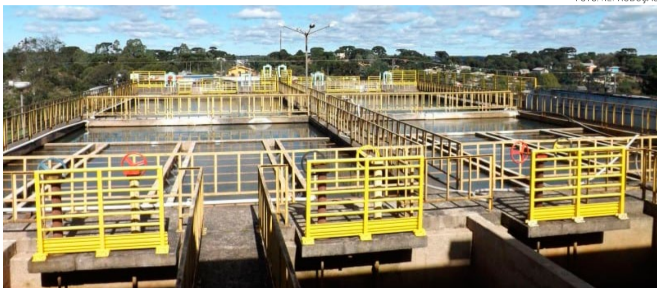
Estação de Tratamento de Água em Canela
