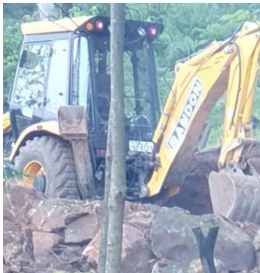
Imagem de uma retroescavadeira da Prefeitura executando serviço de terraplanagem no sítio de Junta, local onde, segundo relatos seria onde Denis futuramente construiria um imóvel
