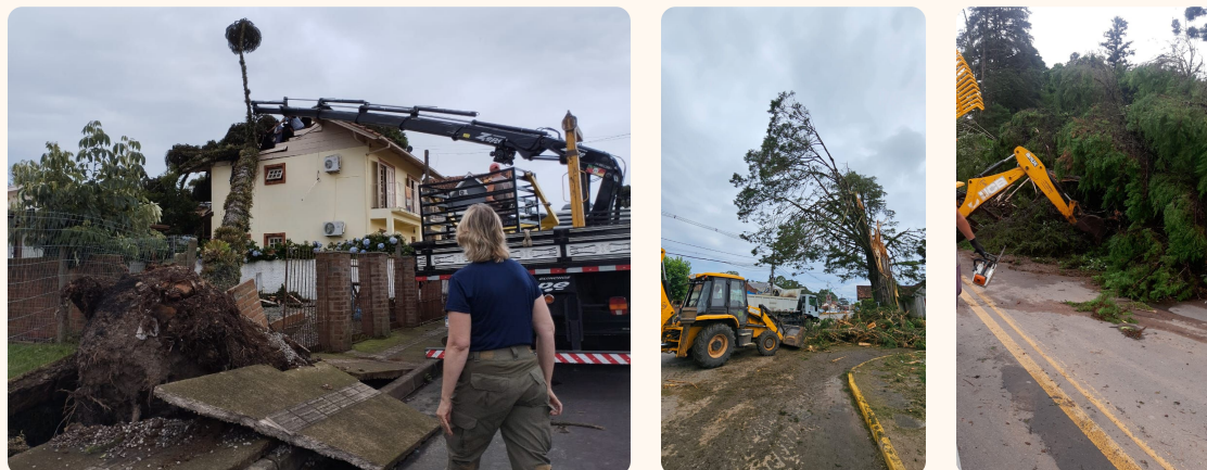
Rua Peru, Av. João Pessoa e Rodovia Arnaldo Oppitz (fotos: Filipe Rocha e Francisco Rocha)
