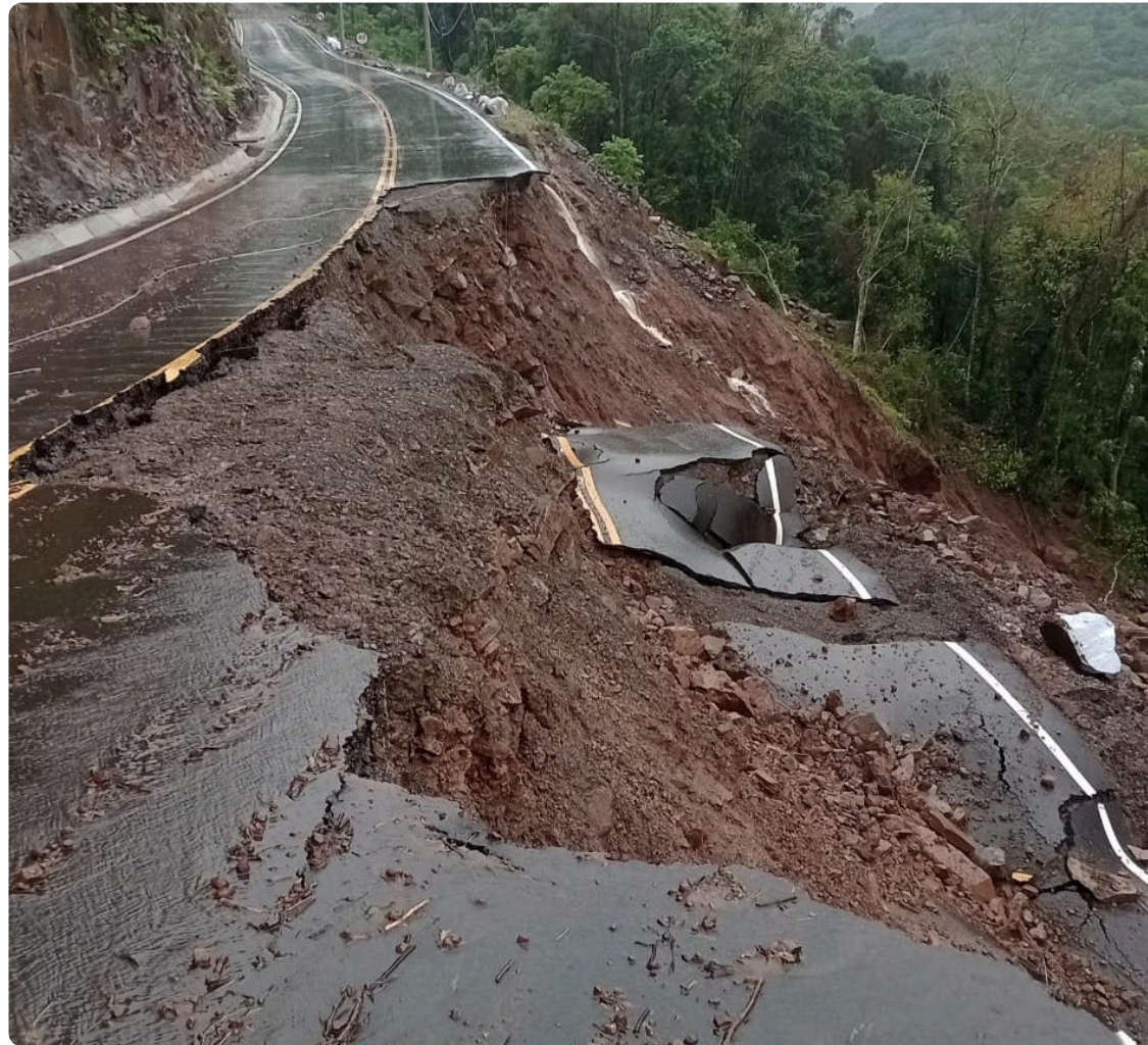
Rota Panorâmica está completamente interditada
